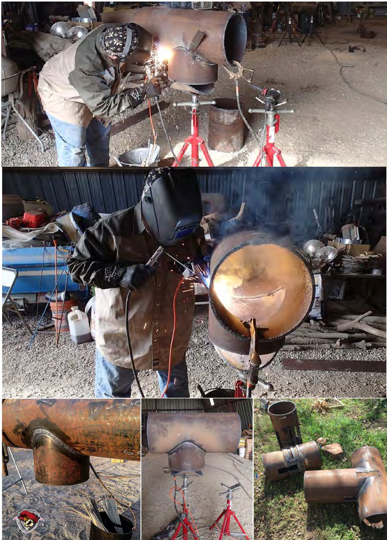
شکل-۵۹۹: آماده سازی و جوش قطعه تست برای تست جوشکار به روش Multiple Qualification
