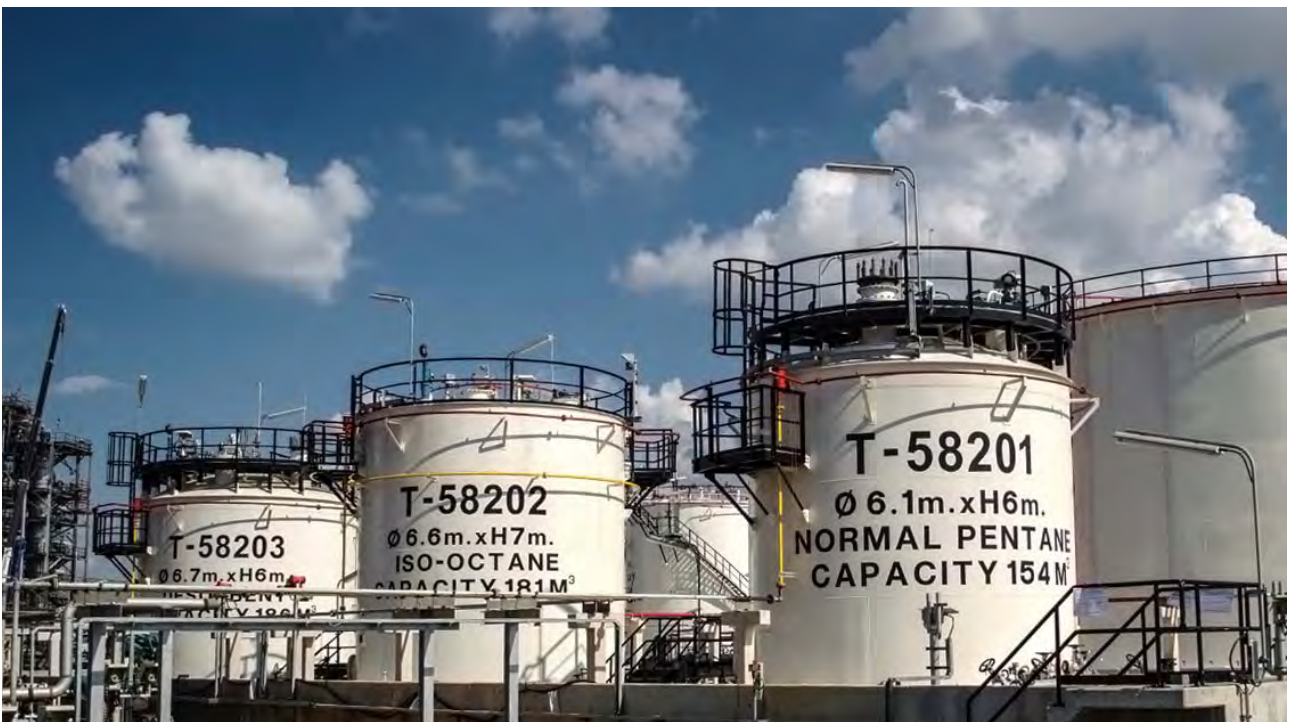
شکل-۹: مخازن ذخیره ای سقف شناور (تصویر بالا) و سقف ثابت با سازه های بیرونی آنها (تصویر پایین)
