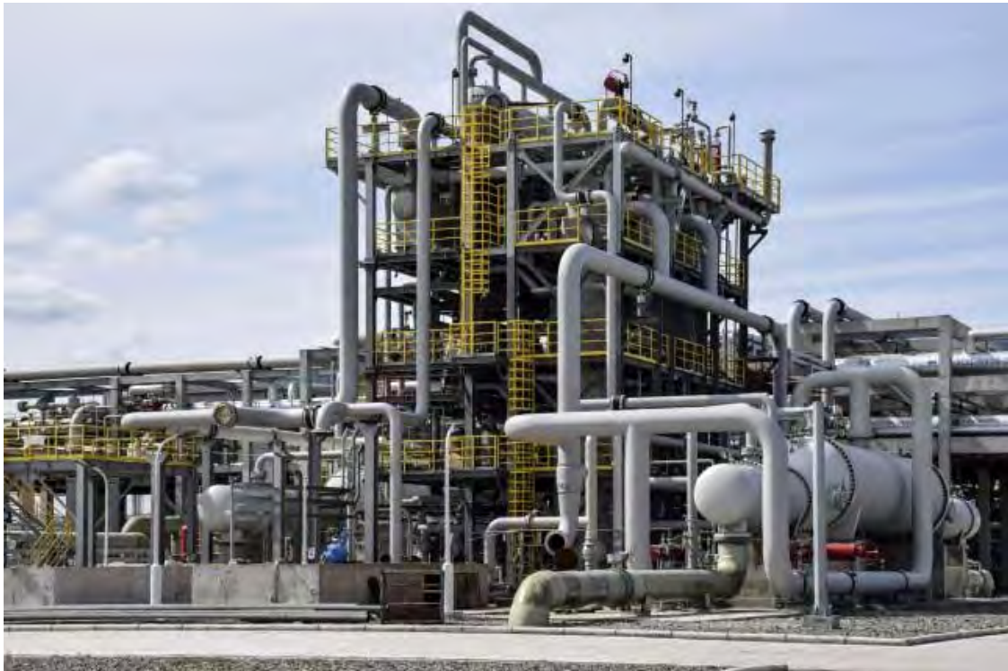
شکل - ۵۷۰ : نمایی از Piping در پالایشگاه
