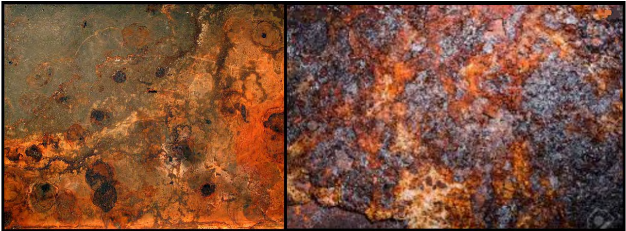
شکل-۳۹۱: نمایی از وضعیت اکسیداسیون روی سطح فلز
