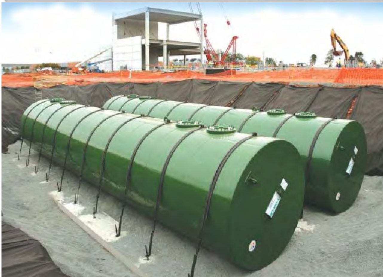
شکل-۲۰: نمونه هایی از نصب مخازن زیر زمینی
