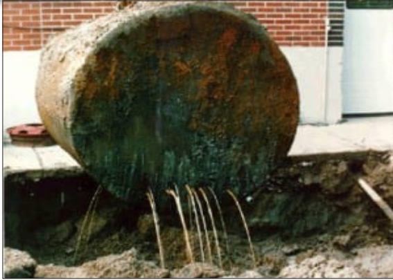
شکل ۸- نشتی مخازن ناشی از خوردگی
